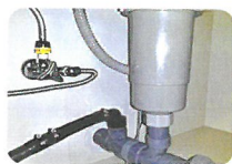
例) 食洗機の配管
